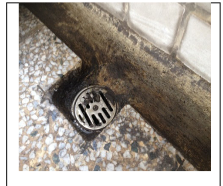
各樓層、頂樓排水孔要疏通
